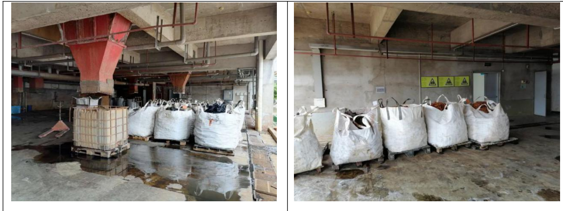
图 5-2 废水处理站图
